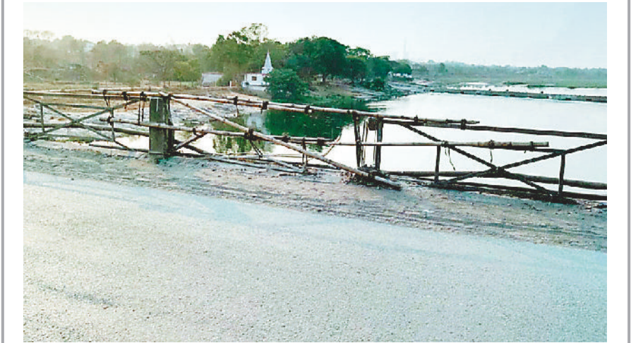
जांजगीर-चांपा। जांजगीर और चांपा शहर को जोड़ने वाला मुख्य गेमन पुल समय के साथ जर्जर अवस्था में आ चुका है। पुल की रेलिंग भी टूट चुकी है जिसे बांस बल्ली से सहारा देकर काम चलाया जा रहा है। ऐसे में भीषण दुर्घटना की संभावना बनी हुई है।
